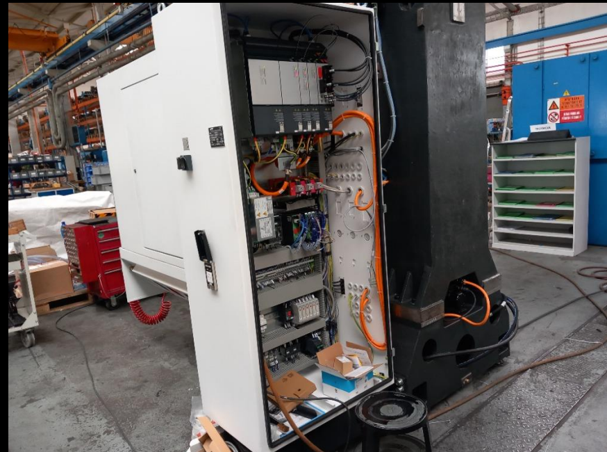
Srdce stroje - elektroinstalace
